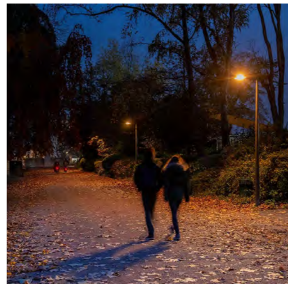
Abb. 42 Mastleuchten entlang der Wege und Plätze
